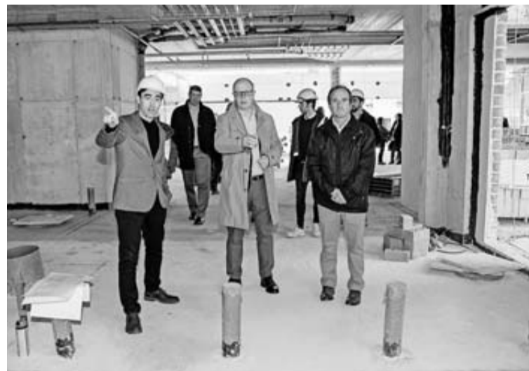
El arquitecto Oscar Mongay, con casco, explica el edificio al consejero Carlos Gimeno y al alcalde de Aranguren, Manuel Romero.
