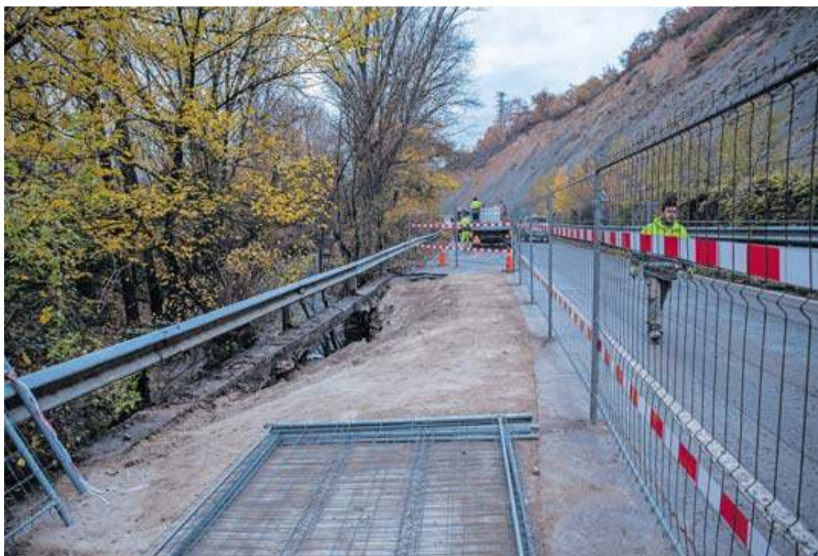
Aspecto de la zona del desprendimiento ayer por la tarde, mientras se cercaba el terreno.
